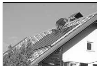
Liegt die Installation 20 Jahre zurück, endet die EEG-Förderung Bildquelle: KEA
