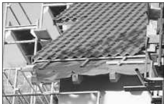
Gut gedämmt, ist halb gelüftet Bildrechte: KEA,
